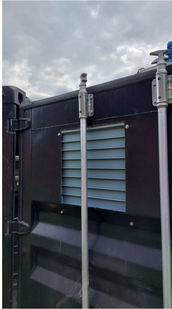
Abb. 7 Zuluftjalousien an der Containerstirnseite
